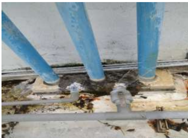
圖三 頂樓給水管破裂
